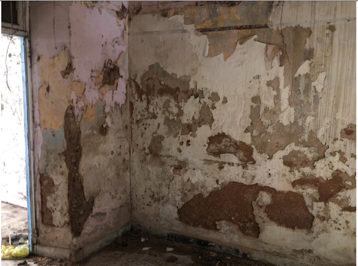
IMAGEN 4. GRIETAS EN MUROS DE MAMPOSTERÍA DE TAPIA
