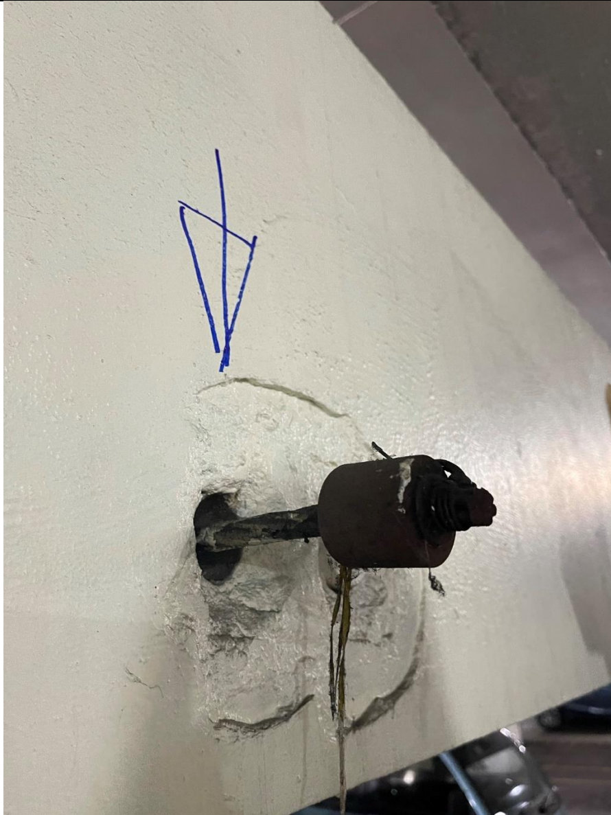
IMAGEN 4. ACERO DE POSTENSADO QUE CEDIO
