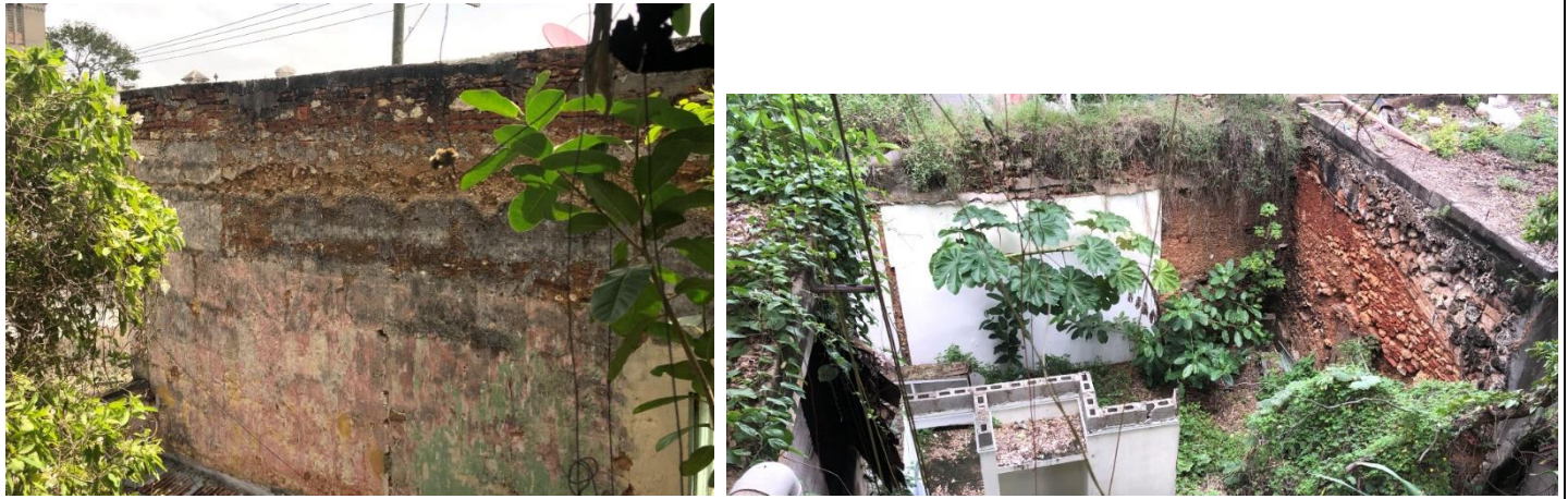
IMAGEN 2. MUROS DE TAPIA AL DESCUBIERTO Y SIN TECHO
