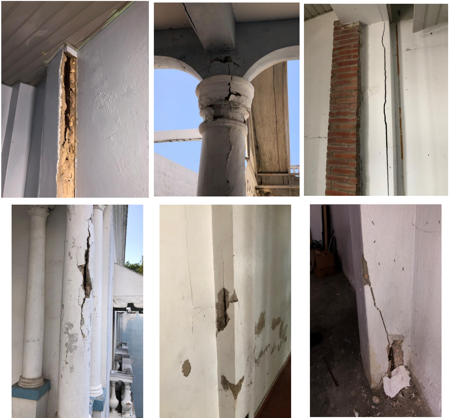
IMAGEN 2. DESPRENDIMIENTO DEL RECUBRIMIENTO DE LAS COLUMNAS DE CONCRETO Y CORROSIÓN EN EL ACERO.
