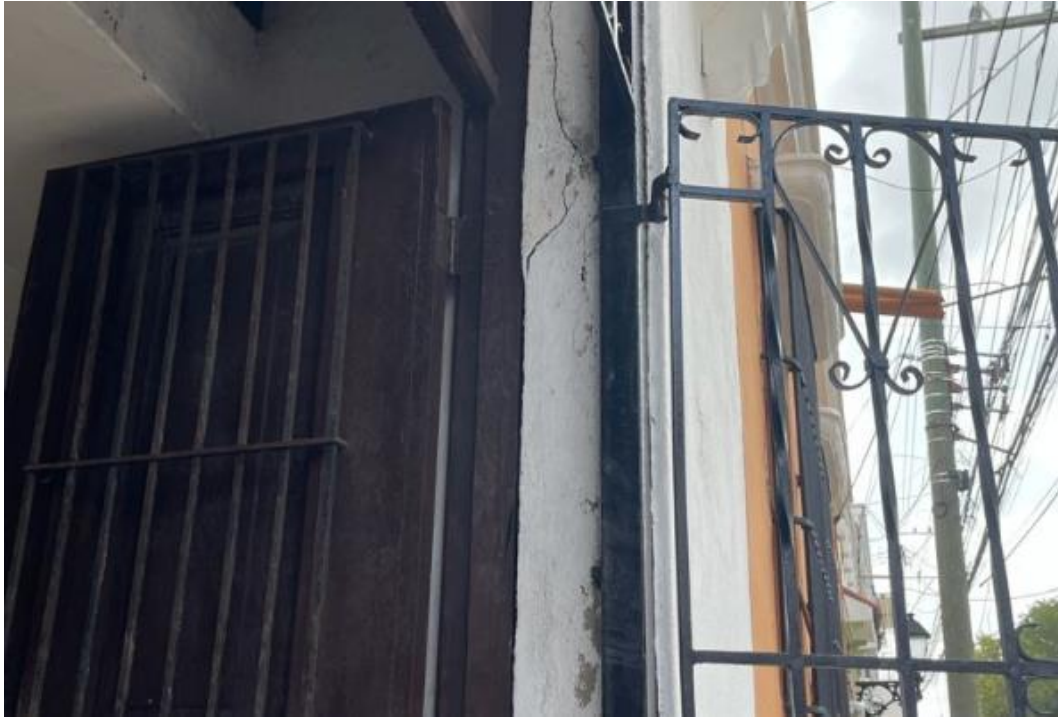
IMAGEN 2. VISTA DE GRIETAS EN DINTELES Y COLUMNA DE ENTRADA
