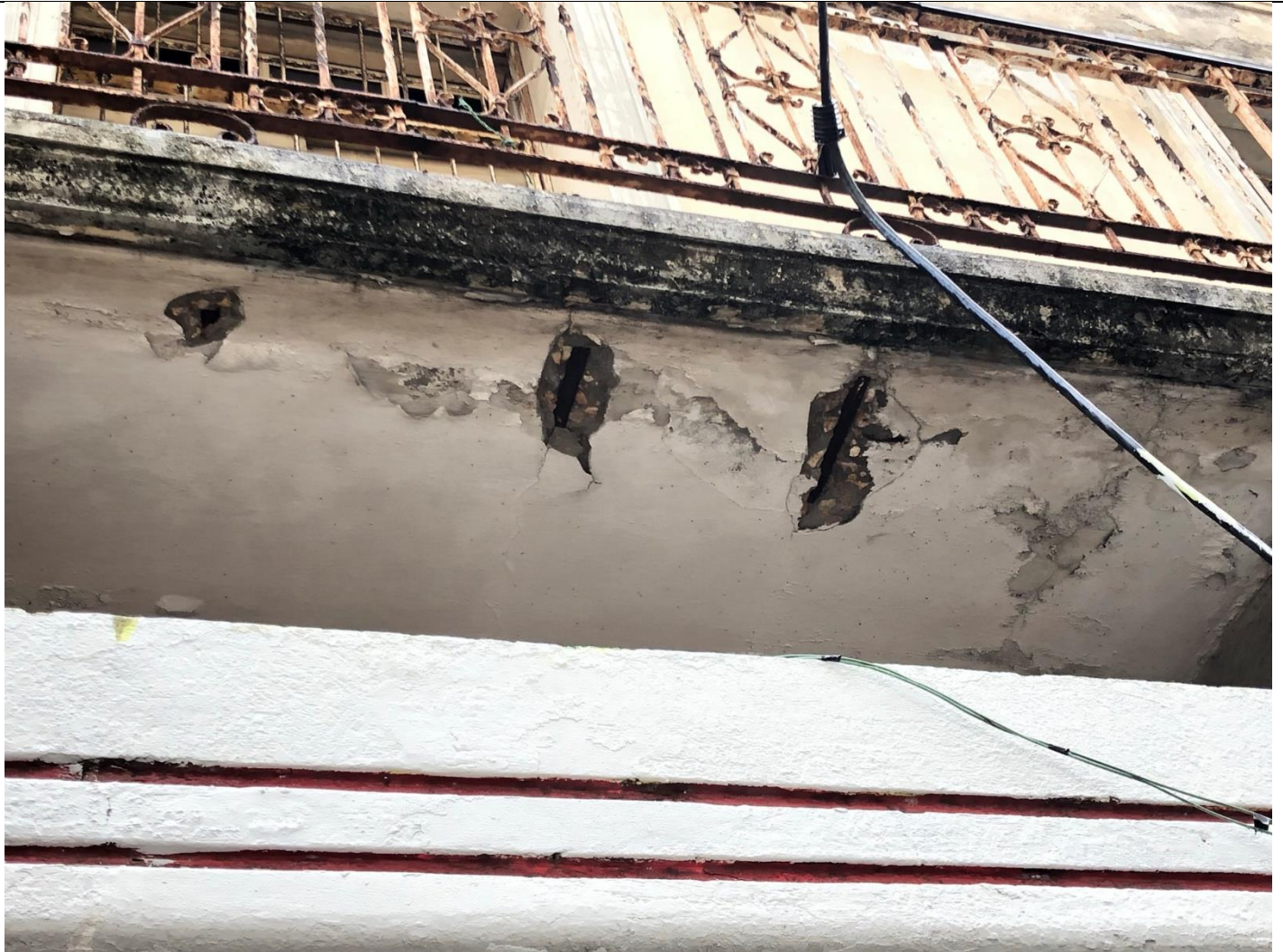
IMAGEN 3. PERDIDA DE RECUBRIMIENTO EN VUELOS DE BALCON.
