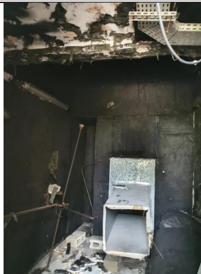
IMAGEN 5. PARTE INCENDIADA DEL EDIFICIO
