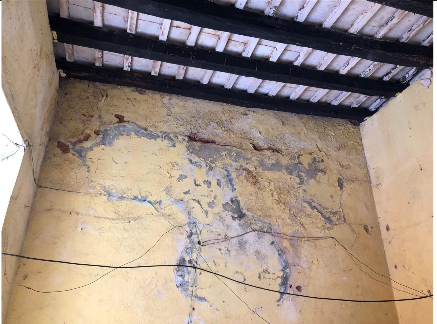
IMAGEN 6. MUROS INTERNOS FISURADOS
