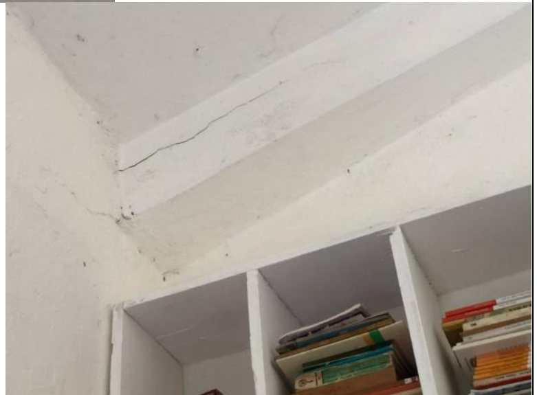
IMAGEN 6. GRIETAS LAS VIGAS DE LA EDIFICACIÓN
