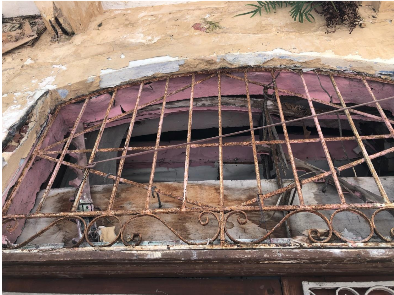
IMAGEN 3. GRIETAS EN MUROS Y DINTELES DE MAMPOSTERÍA DE TAPIA
