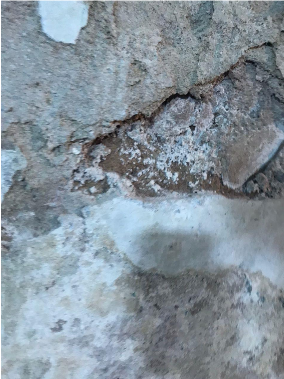
IMAGEN 3. GRIETAS EN MUROS
