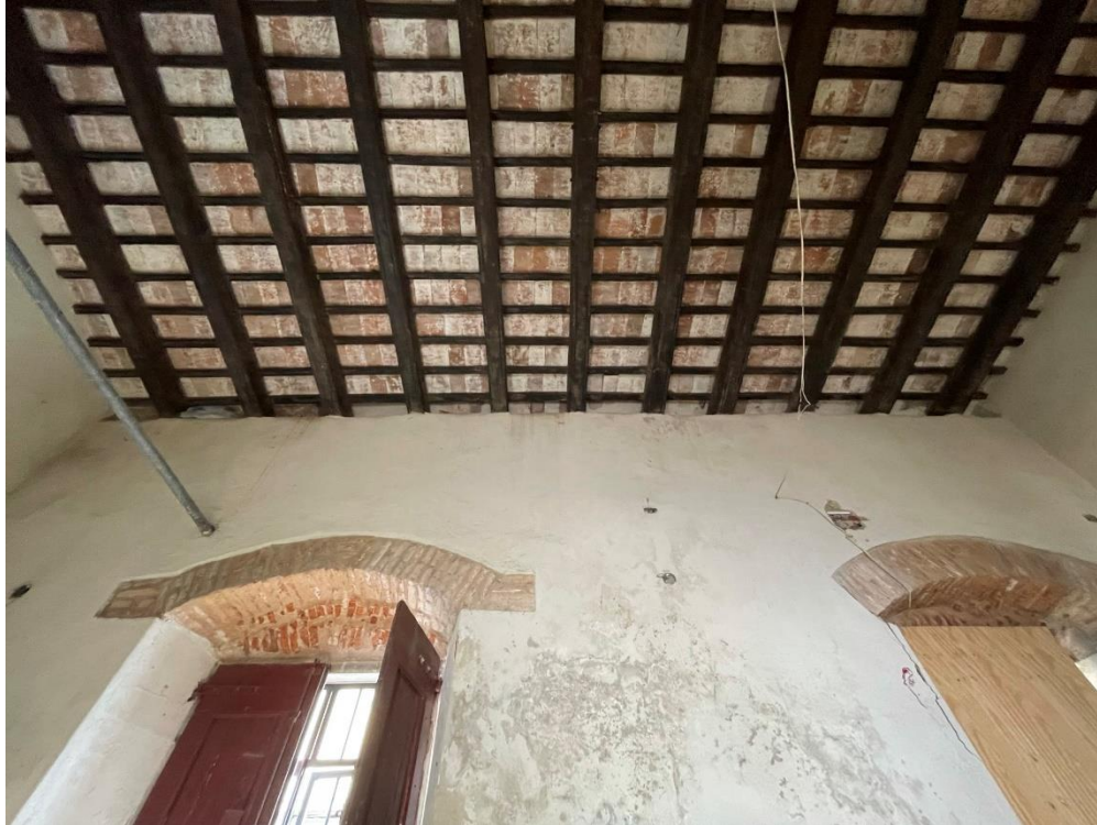
IMAGEN 4. DESGASTE DE VIGAS DE MADERA.
