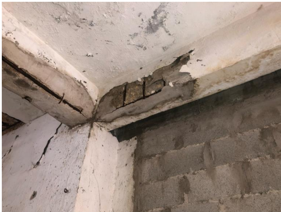
IMAGEN 5. DESPRENDIMIENTO DE RECUBRIMIENTO DE LAS VIGAS Y ACERO EXPUESTO
