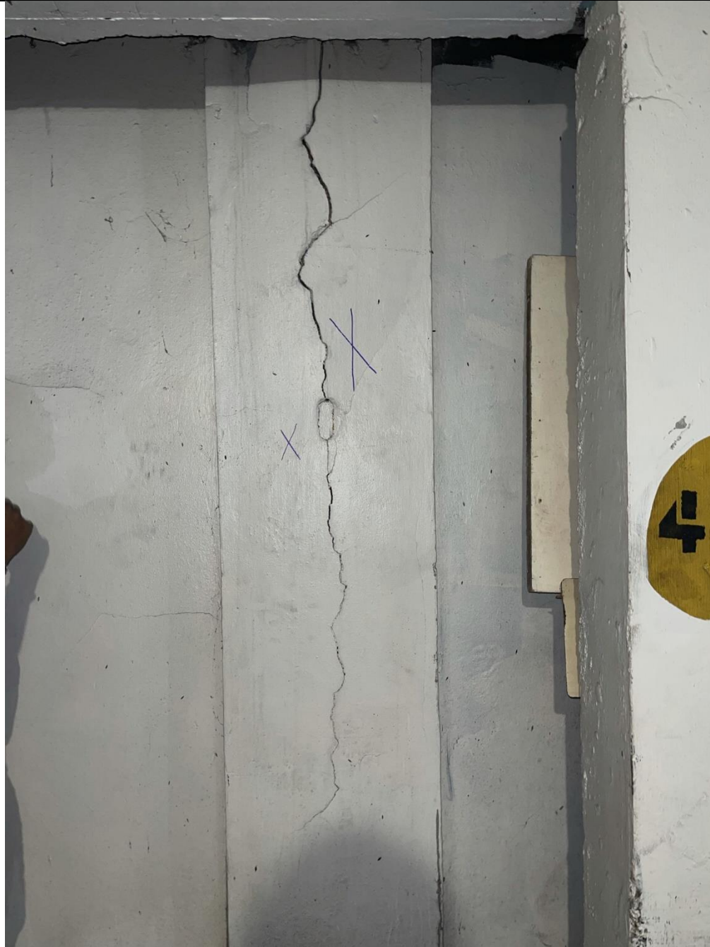
IMAGEN 3. GRIETAS EN COLUMNAS DE HORMIGÓN ARMADO
