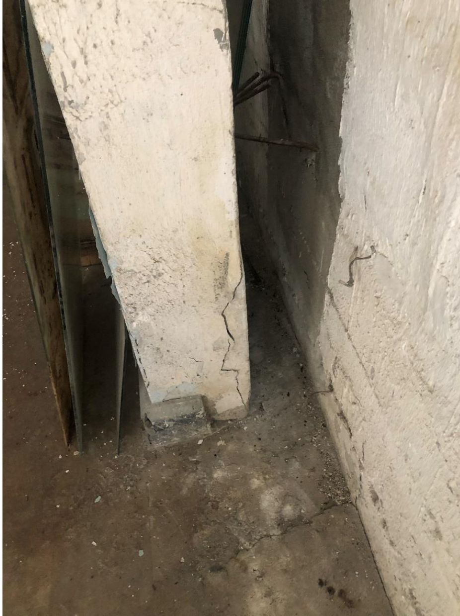
IMAGEN 6. GRIETAS EN COLUMNA DEL SEGUNDO NIVEL
