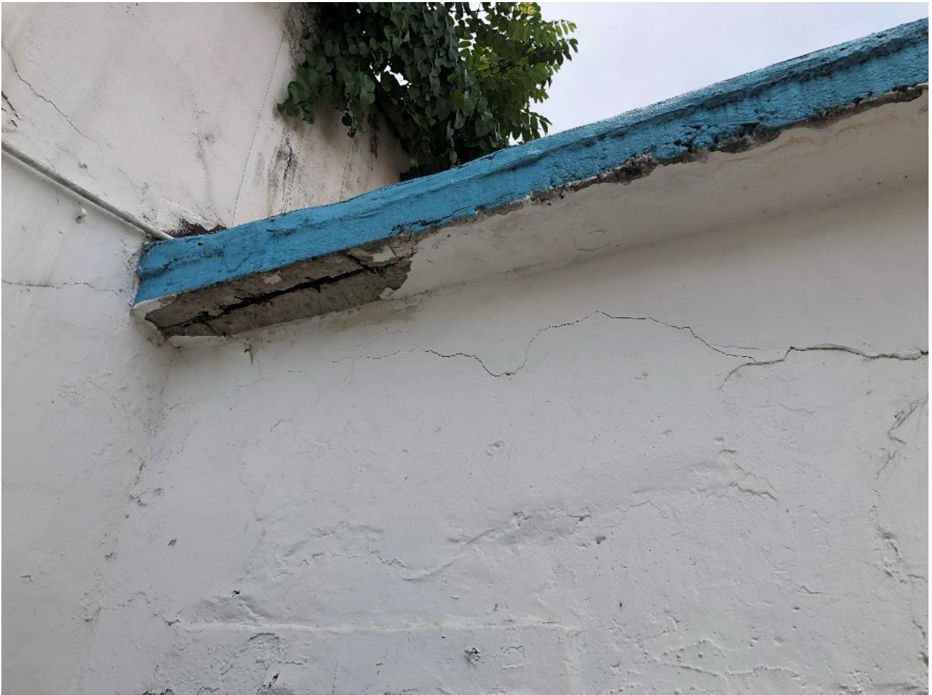
IMAGEN 4. LOSA EN VOLADIZO CON RECUBRIMIENTO DESPRENDIDO Y ACERO EXPUESTO.
