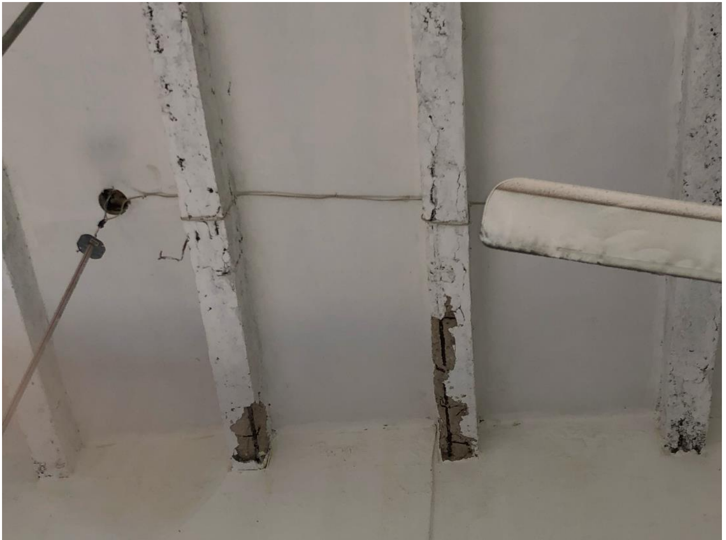
IMAGEN 7. DESPRENDIMIENTO DEL RECUBRIMIENTO DE LAS VIGAS DE CONCRETO.
