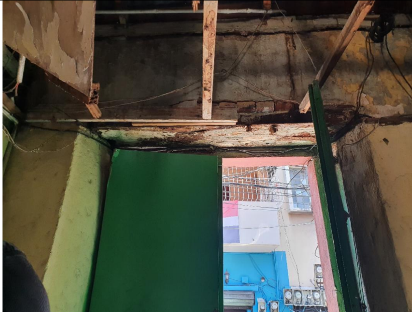
IMAGEN 6. GRIETAS EN EL DINTEL DE ENTRADA A LA EDIFICACION
