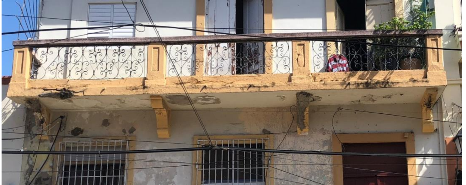
IMAGEN 3. DETERIORO DE VUELOS EN LA PARTE FRONTAL DEL EDIFICIO (CALLE LAS MERCEDES)
