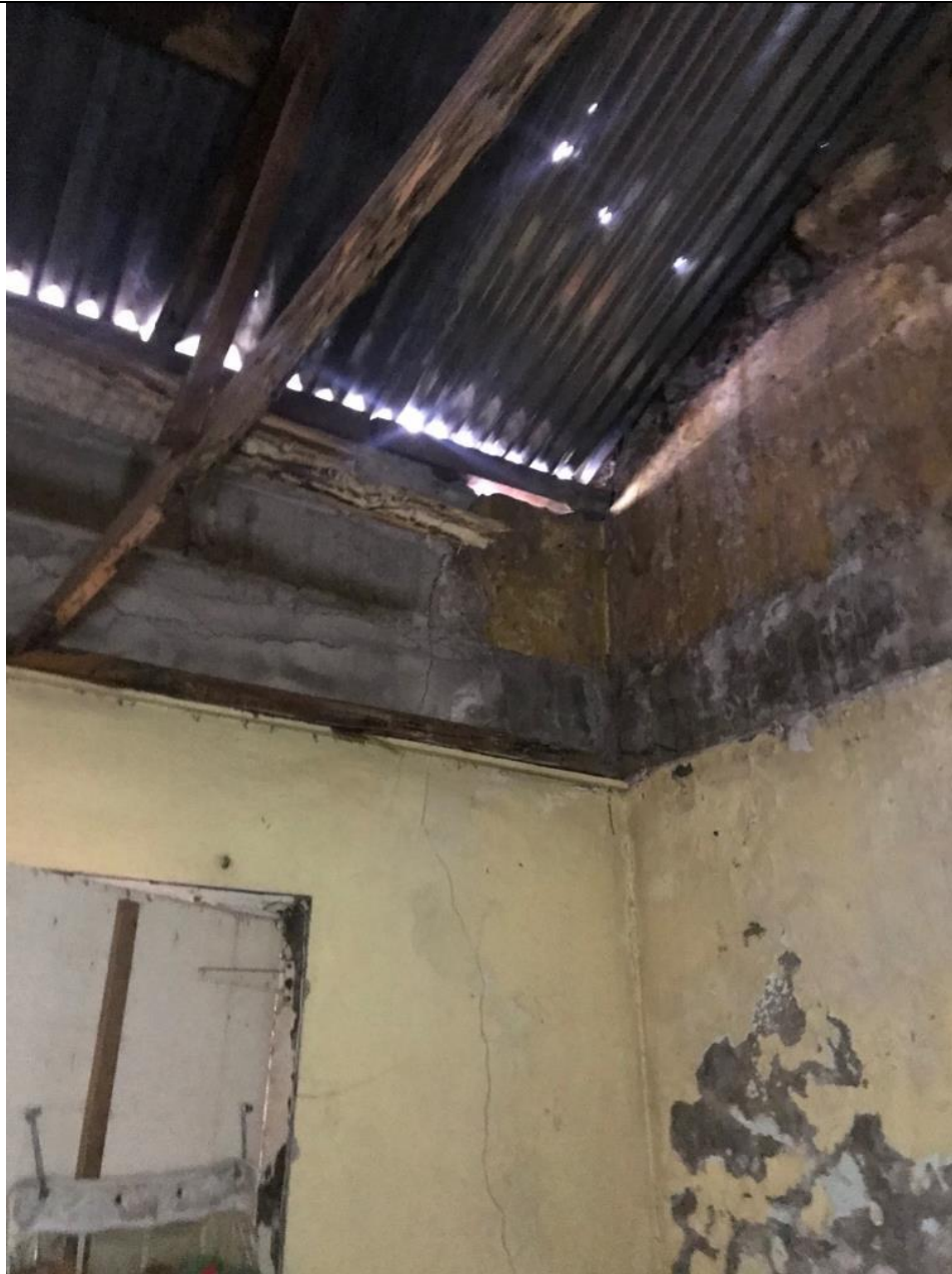
IMAGEN 5. GRIETAS EN MUROS DE MAMPOSTERÍA DE TAPIA
