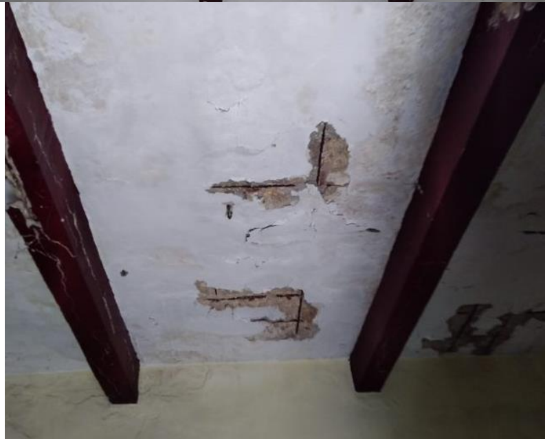
IMAGEN 4. DESPRENDIMIENTO DEL RECUBRIMIENTO DEL TECHO Y CORROSIÓN EN EL ACERO.
