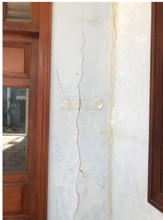
IMAGEN 4. GRIETAS EN MAMPOSTERÍA DE BLOQUES DE CONCRETO Y ACERO EXPUESTO.
