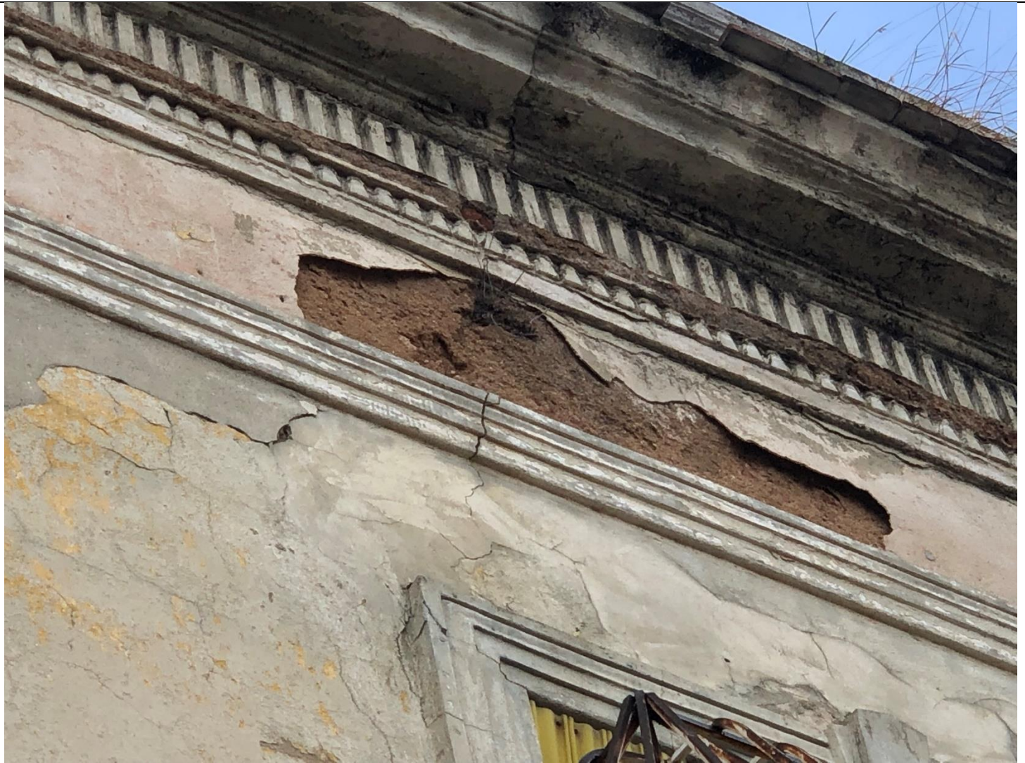
IMAGEN 4. GRIETAS EN MUROS DE MAMPOSTERÍA DE TAPIA
