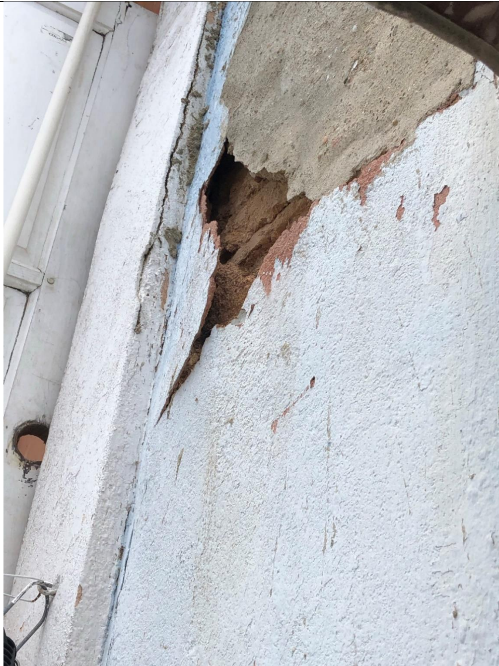
IMAGEN 3. GRIETAS EN MUROS DE MAMPOSTERÍA DE TAPIA
