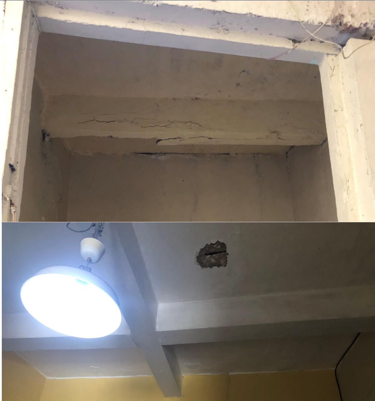
IMAGEN 5. GRIETAS EN VIGAS DE CONCRETO ARMADO Y DESPRENDIMIENTO DE RECUBRIMIENTO EN LOSAS
