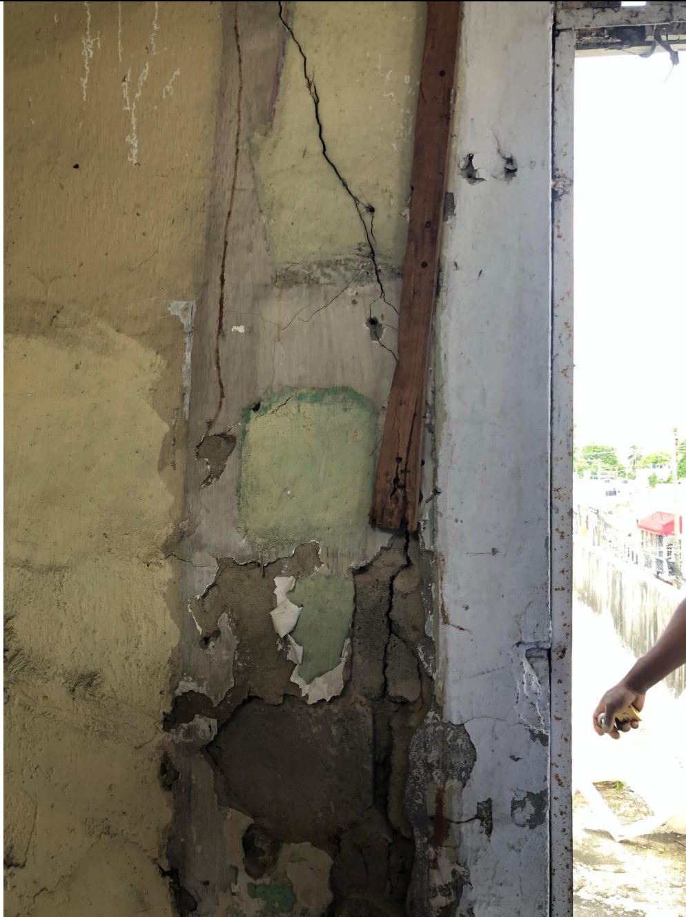
IMAGEN 4. GRIETAS EN MUROS DE HORMIGÓN
