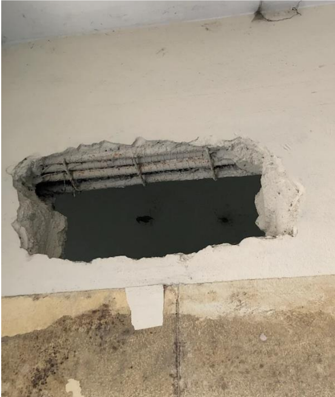
IMAGEN 3. DESPRENDIMIENTO DE RECUBRIMIENTO DE LAS VIGAS Y ACERO EXPUESTO, PRODUCTO DE REMODELACIONES.
