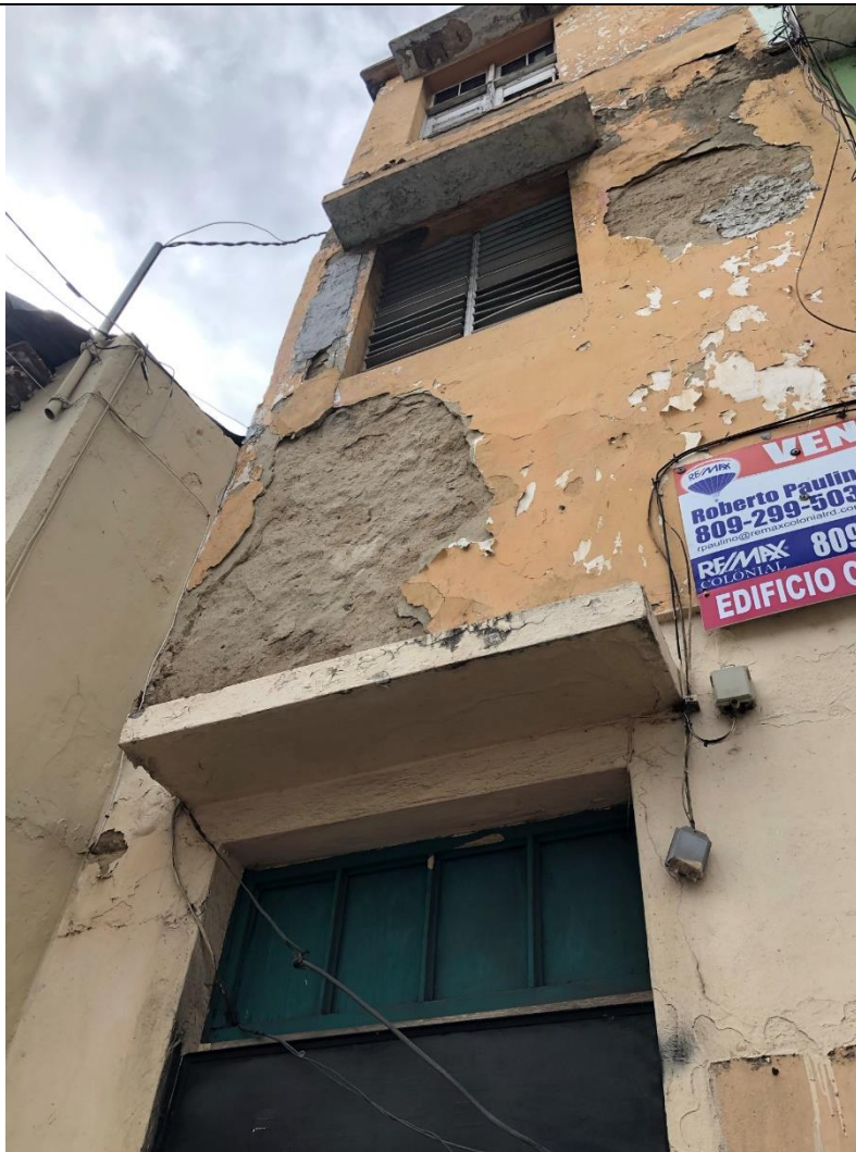
IMAGEN 3. CUBIERTA INFERIOR DE TECHO DESPRENDIDA
