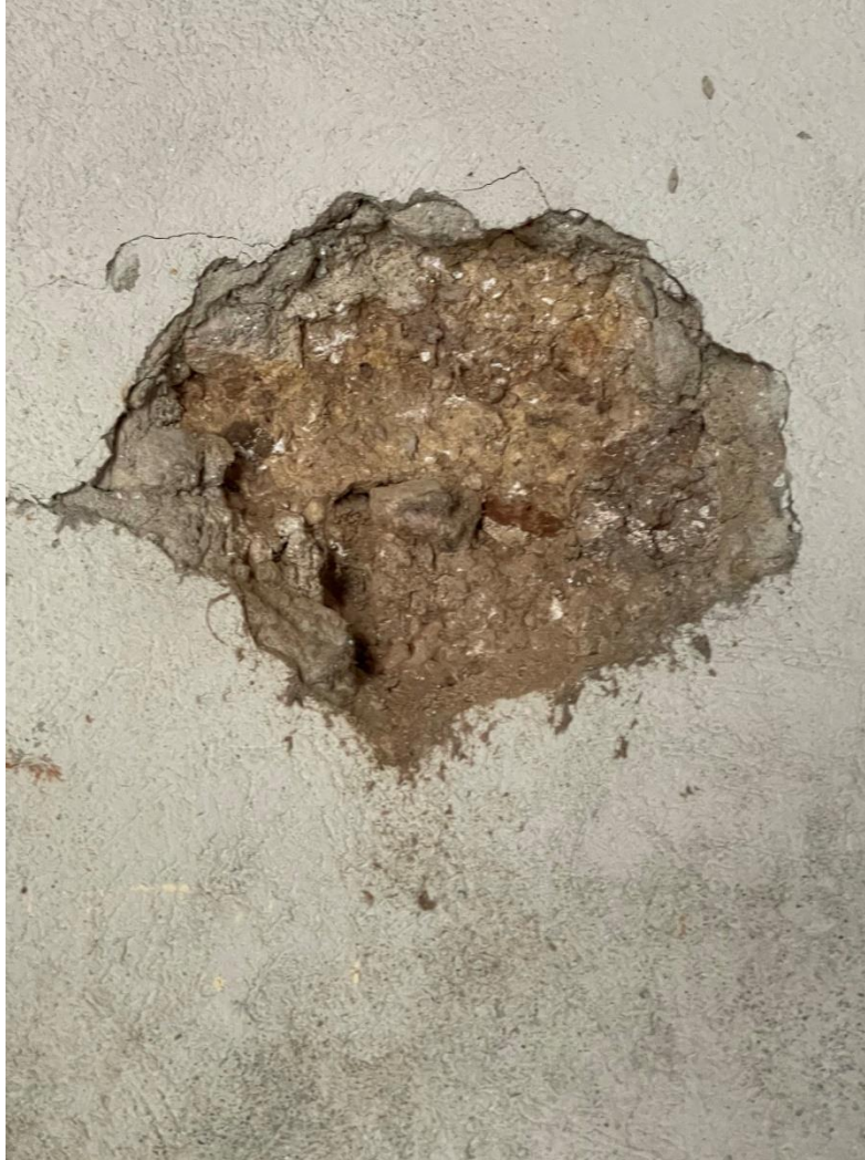
IMAGEN 5. DESPRENDIMIENTO DE RECUBRIMIENTO DE LOS MUROS.
