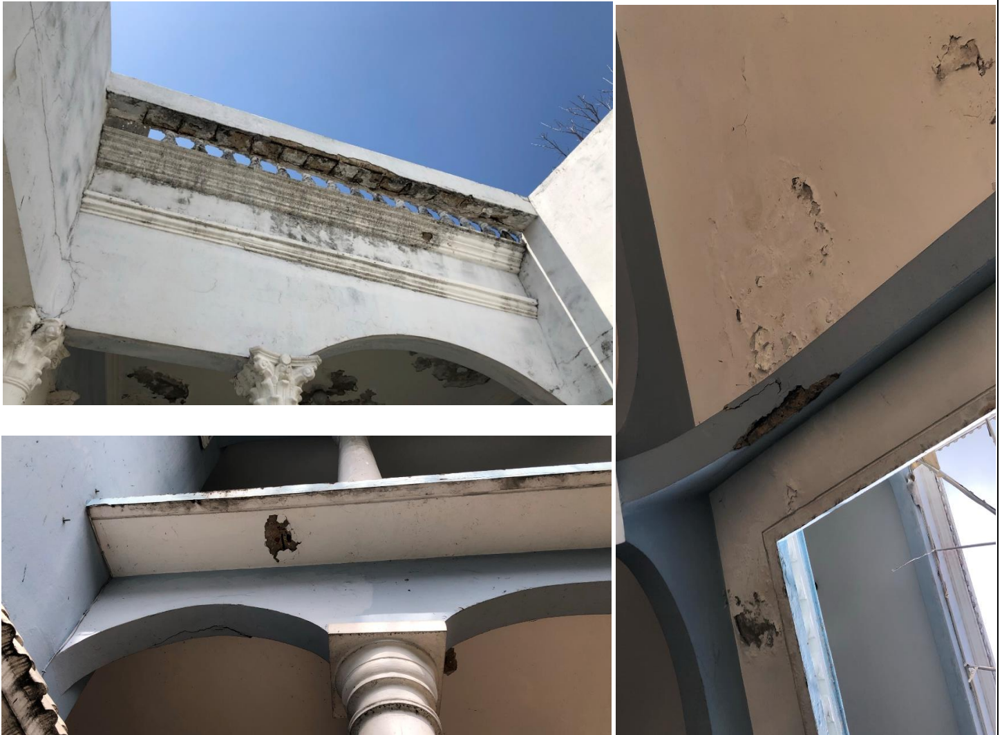
IMAGEN 3. DESPRENDIMIENTO DE RECUBRIMIENTO DE LAS VIGAS Y ACERO EXPUESTO.
