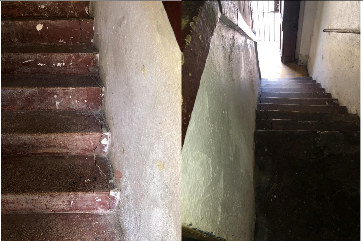
IMAGEN 4. GRIETAS DE EN ESCALERAS
