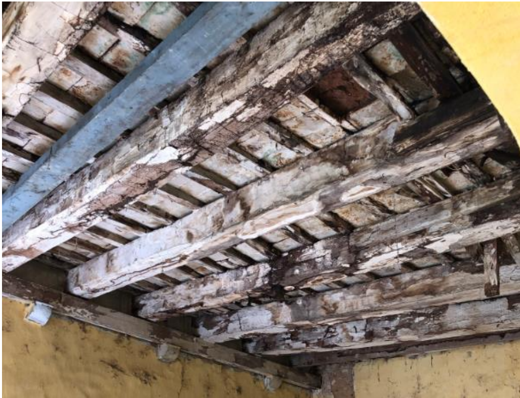
IMAGEN 4. DETERIORO EN LOSAS DE CONCRETO Y ENTRAMADO DE MADERA
