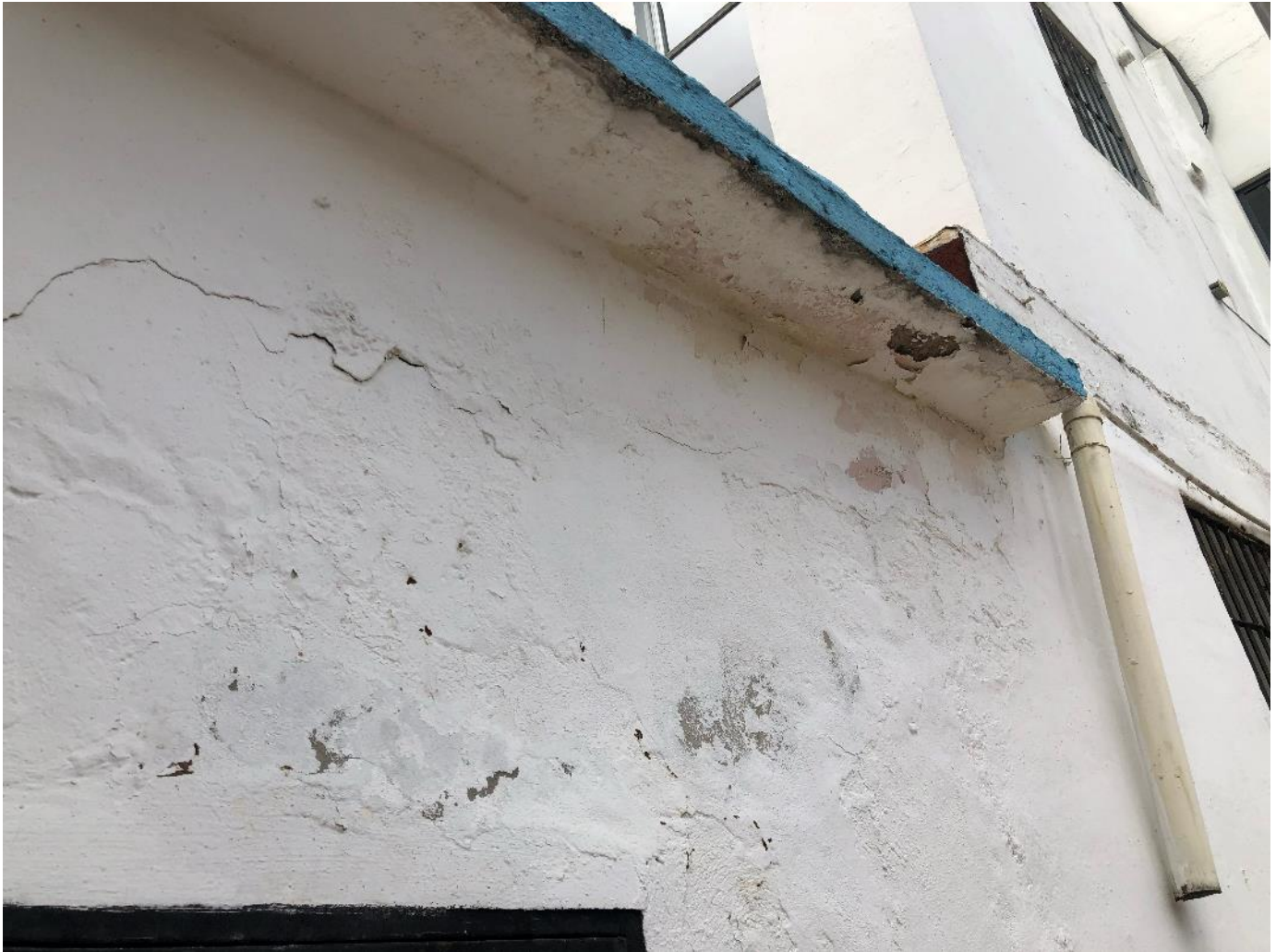
IMAGEN 5. GRIETAS EN MUROS DE MAMPOSTERÍA DE LA PARTE INTERIOR DEL EDIFICIO.
