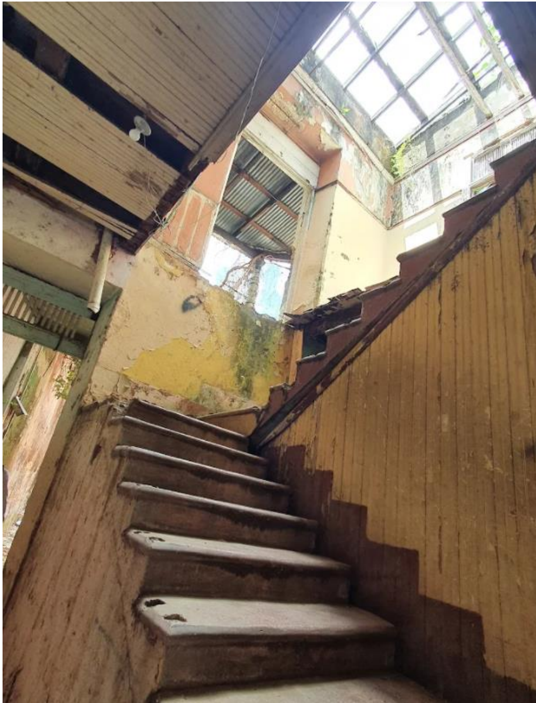
IMAGEN 4. ESCALERA DE ACCESO AL SEGUNDO NIVEL (TECHO COLAPSADO)
