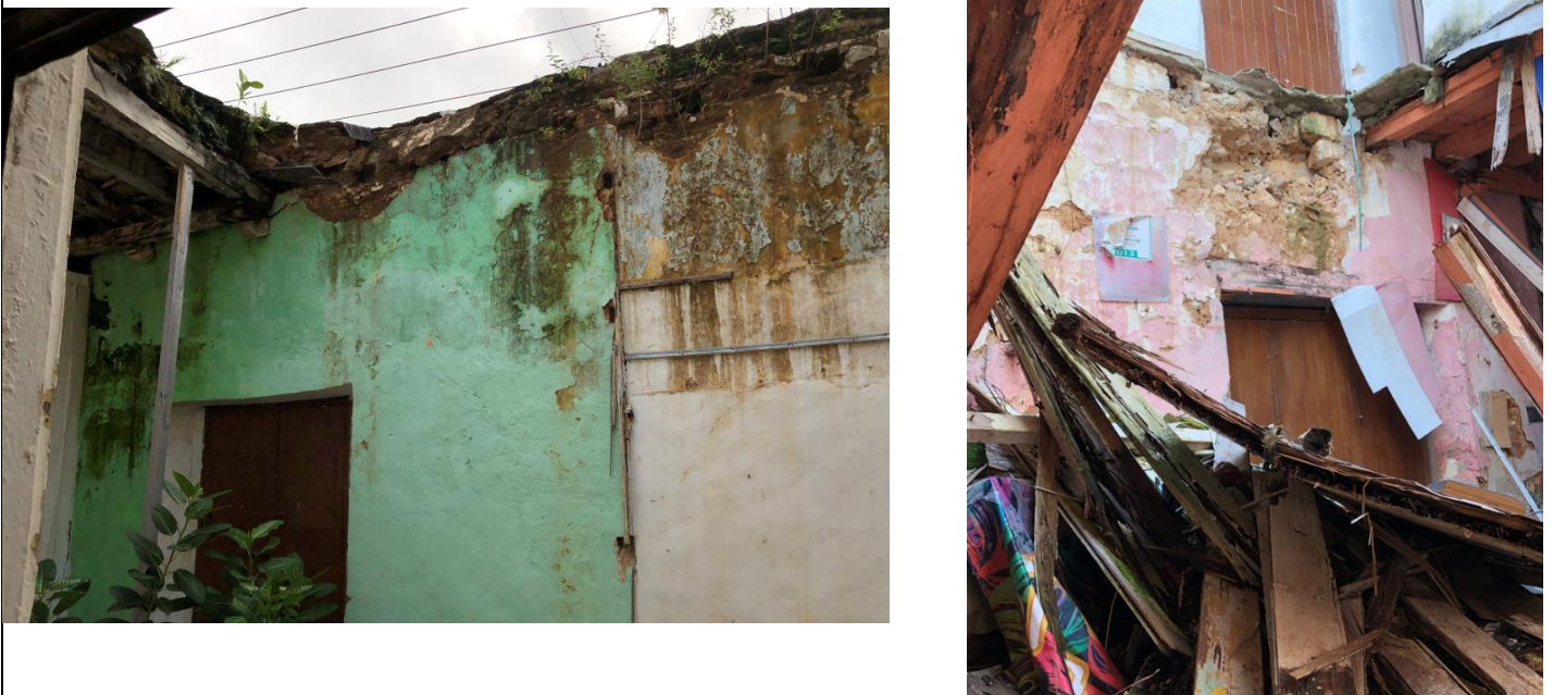
IMAGEN 3. PARTE COLAPSADA DEL SISTEMA DE PISOS
