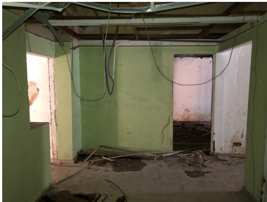
IMAGEN 2. GRIETAS EN MUROS DE MAMPOSTERÍA DE TAPIA
