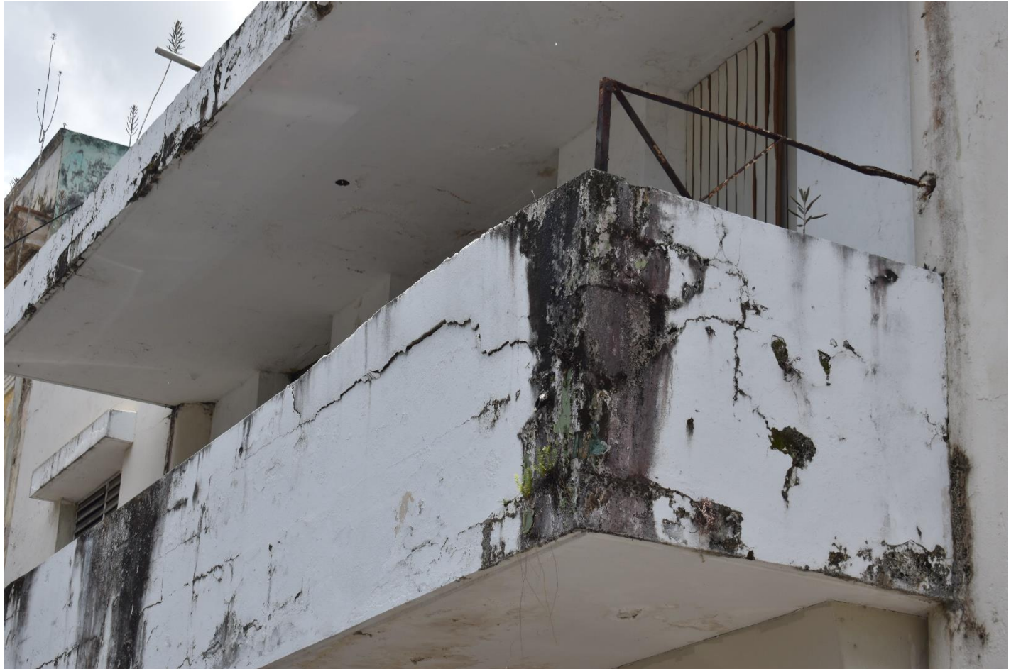
IMAGEN 8. VOLADIZO EN MAL ESTADO EN CALLE 19 DE MARZO
