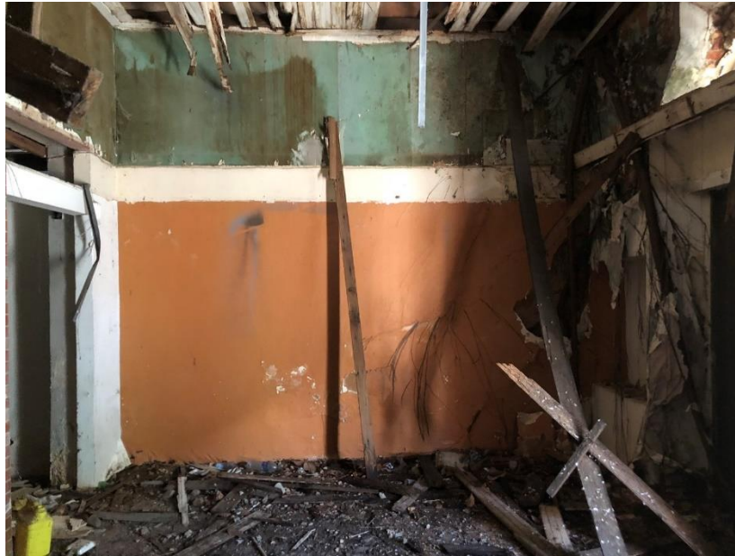
IMAGEN 1. CUBIERTA INFERIOR DE TECHO DESPRENDIDA
