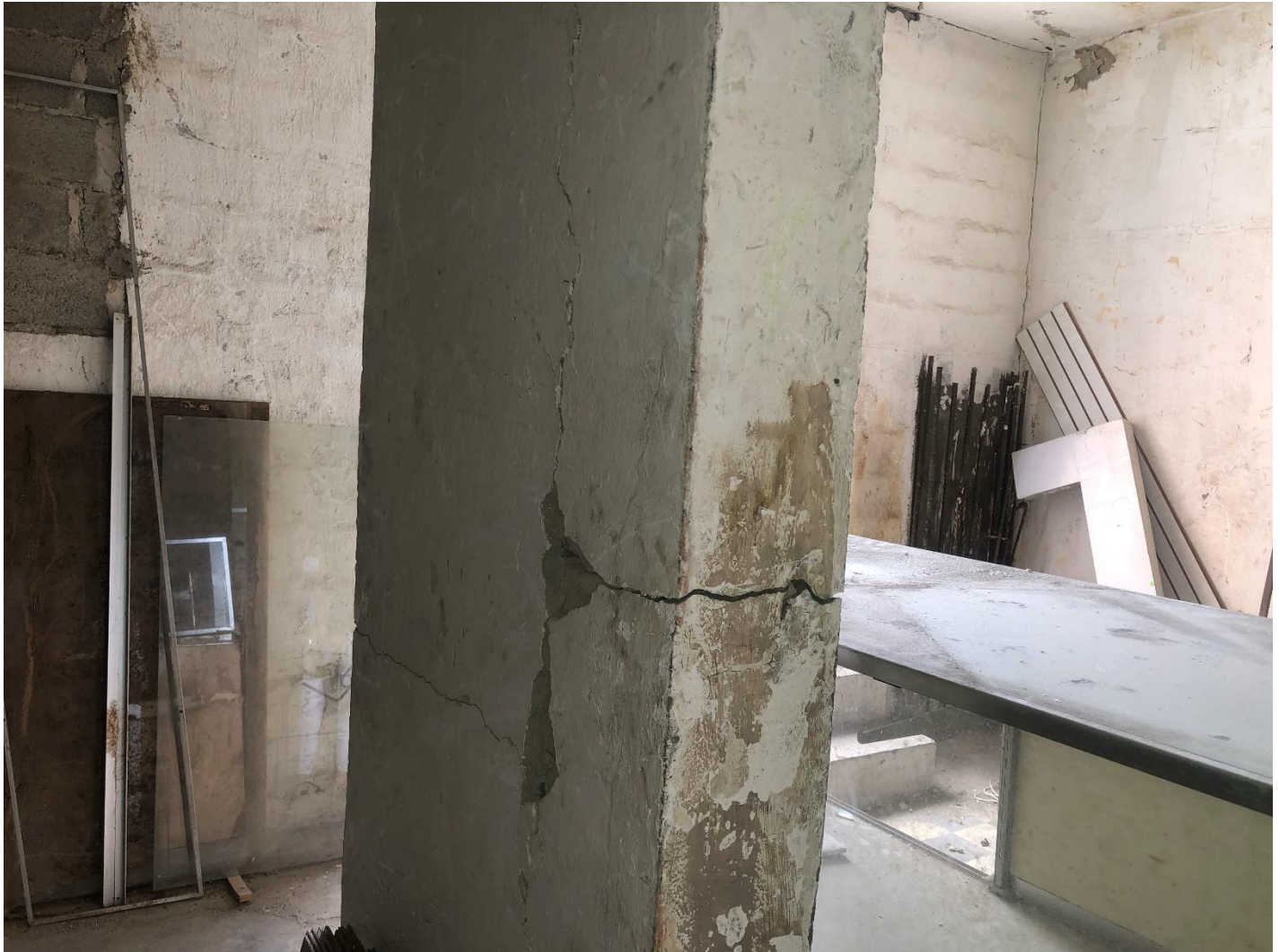
IMAGEN 7. GRIETAS EN MAMPOSTERÍA DE BLOQUES DE CONCRETO
