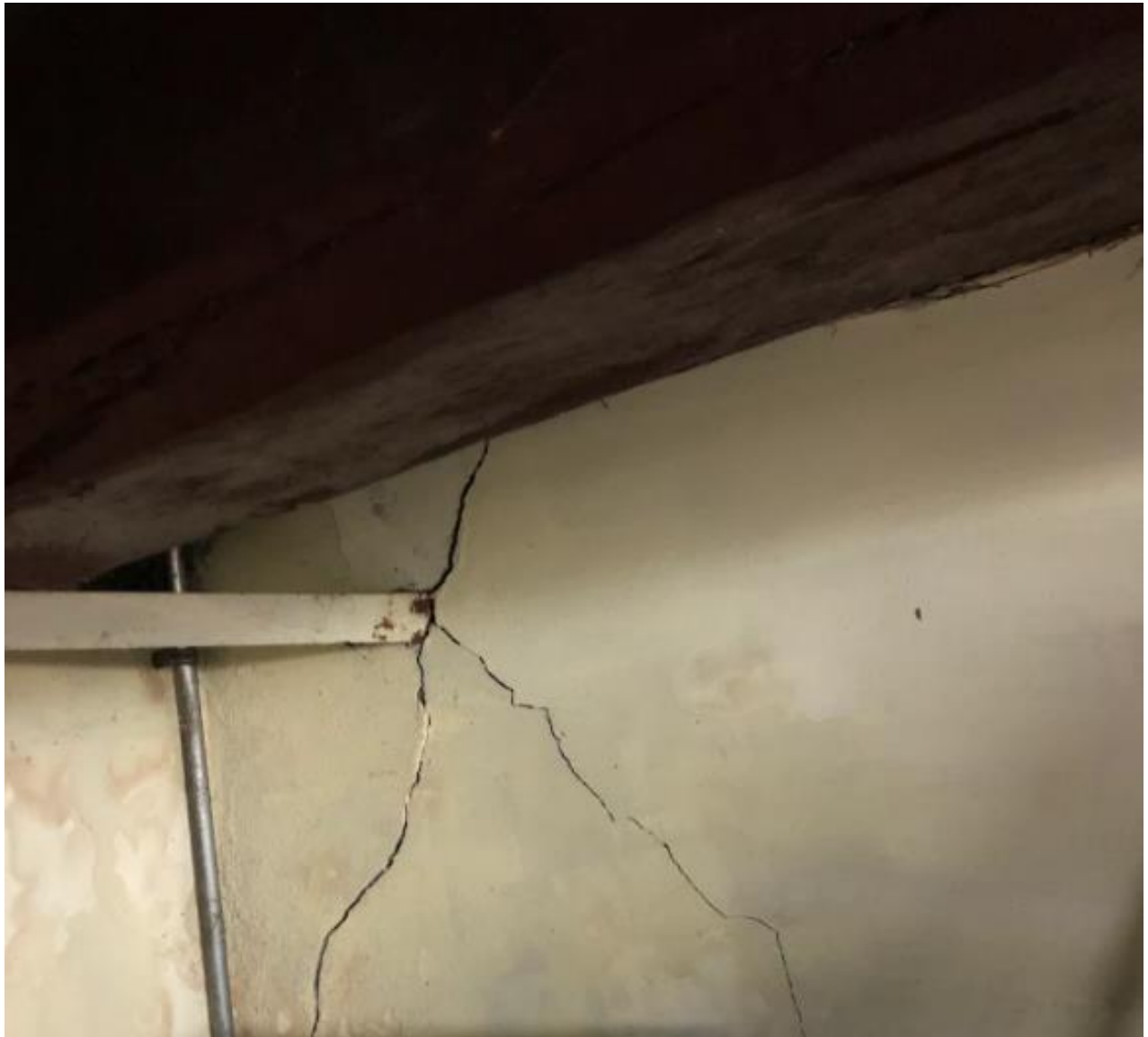
IMAGEN 3. GRIETAS EN MUROS DE MAMPOSTERIA EN PARTE INTERIOR DEL EDIFICIO (CONEXIÓN CON TECHO DE MADERA)
