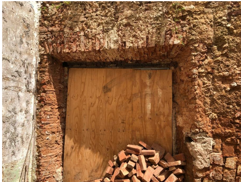
IMAGEN 4. CONDICIÓN ACTUAL DE LOS DINTELES DE LA EDIFICACIÓN
